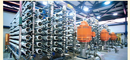
Die Abwasserbehandlung und das -recycling plant CDM Smith für eine neue Fabrik der Hitachi Gruppe in Texas.
