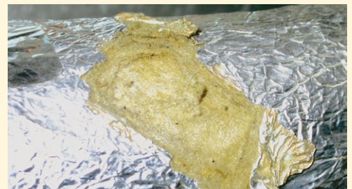
Isolierung mit asbesthaltiger Mineralfaser
