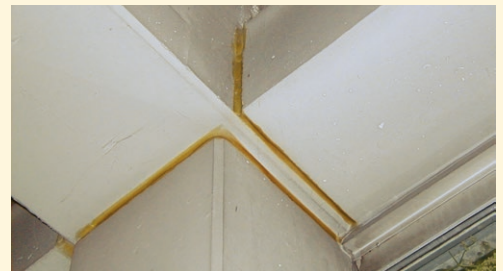
Mit polychlorierten Biphenylen (PCB) belastete Fugenbefüllung
