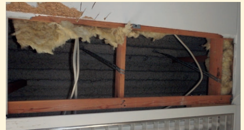
PCB-haltige Abhangdecke mit Mineralwollauflage aus KMF und Spritzasbestbeschichtung an der Deckenunterseite
