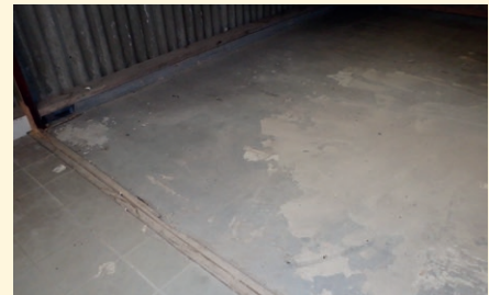
Quecksilberhaltige Farbe auf einem Betonboden
