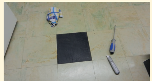
Asbesthaltiger Bodenbelag (Floor-Flex-Platten) und Kleber
