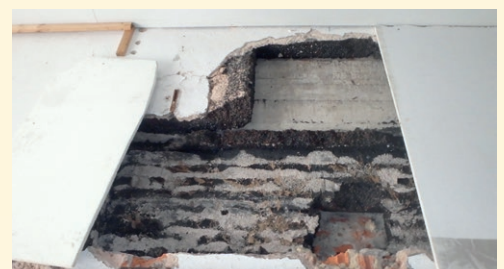
Teerkorkdämmung (PAK) in einem Kühlraum
